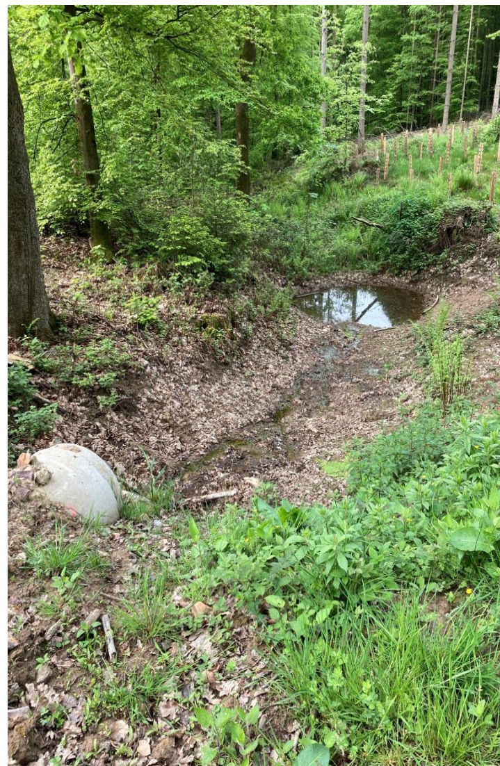
Abb. 34: Gut gelungene Versickerungsmulde unterhalb eines Wegedurchlasses (Foto: H. Puhlmann).
